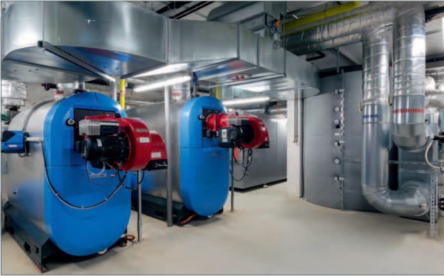
■ Die zwei Blockheizkraftwerke
