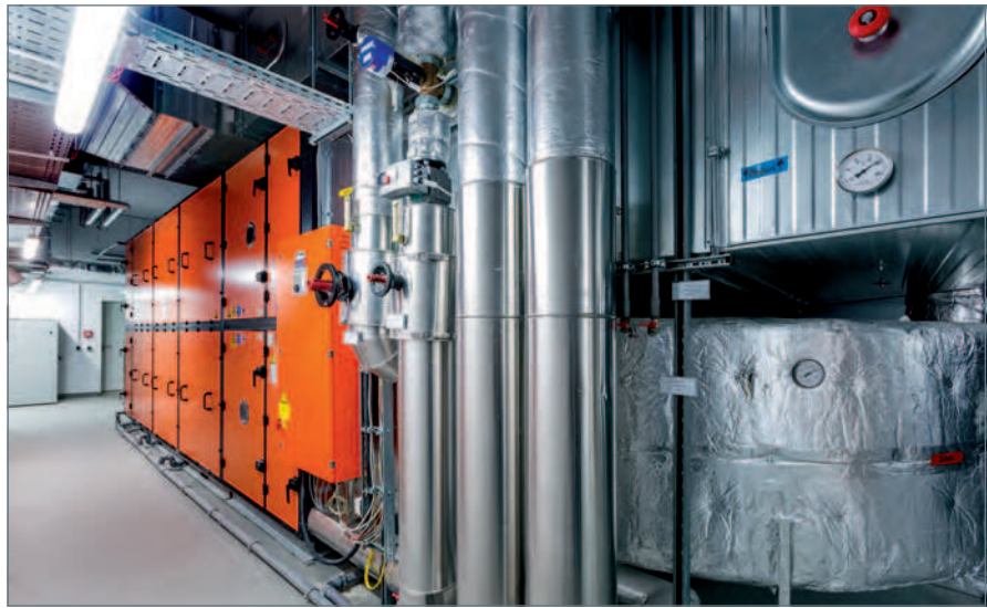
■ Lüftungsanlage mit Zu- und Abluft
